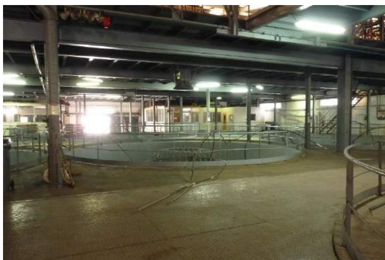
Stockage de réserve d'un câble sous-marin.
